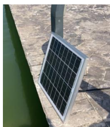
Figura 5.1 – Panoul fotovoltaic cu o putere de 10Wp montat pe malul lacului – SPMS Palazu-Mare
