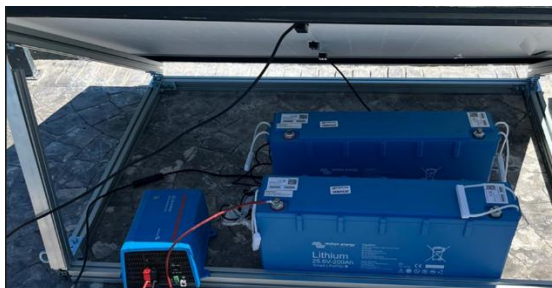
Figura 5.21 – Bateriile LiFePO 4 și invertorul folosite în proiect
