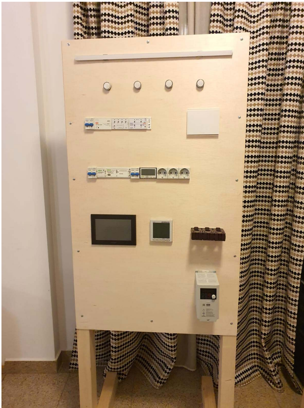
Figura 7. Demonstrator 3 – Panoul de test pentru implementarea soluțiilor inteligente KNX/Modbus și interconectarea sistemelor IoT
