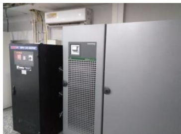
Figura 4.3. UPS-urile de 150 kVA și regulatoarele automate de tensiune situate în camera tehnică
