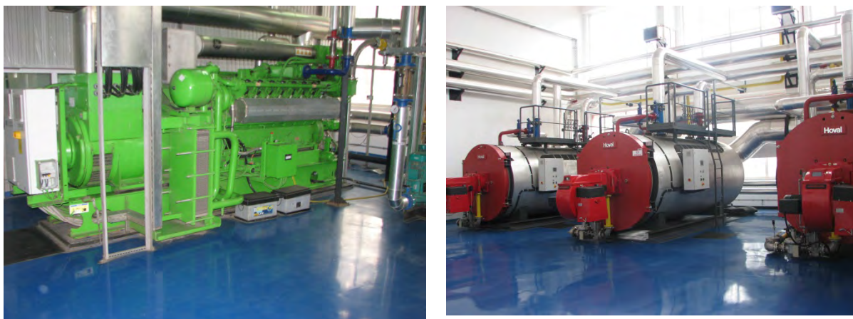
Incintă sală motoare - Centrala Termică
