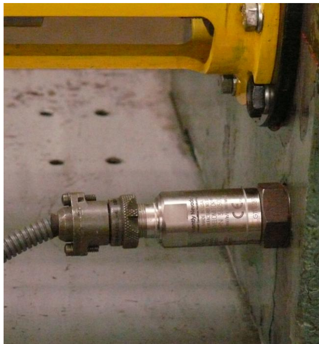
Figura 4.8. Traductor de vibrații Bently Nevada
