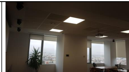
Figura 1. Vedere de ansamblu asupra camerei inteligente (termostat KNX, tableta control secundar, lumini inteligente KNX, sistem home-cinema KNX)
