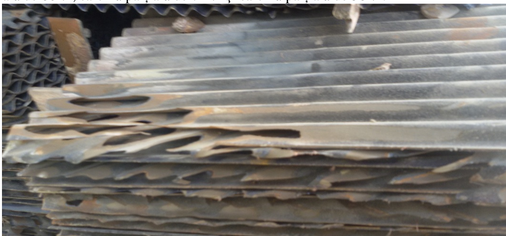
Fig. 5.5. Umplutură metalică corodată a preîncălzitorului de aer uzat, formată din faguri de tablă ondulată
