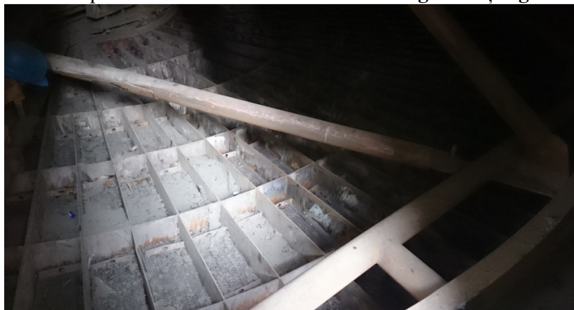
Fig. 5.3.a- Umplură metalică uzată 1- vedere de ansamblu
